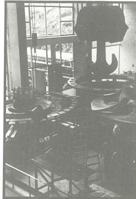
Jurumirim, no rio Paranapanema (97 MW).
