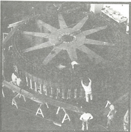
Bariri, no rio Tietê (143 MW).
