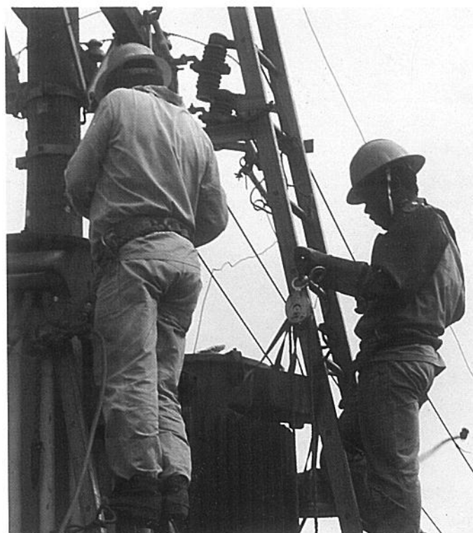
SISTEMA DISTRIBUIDOR Baixa e Média Tensão
